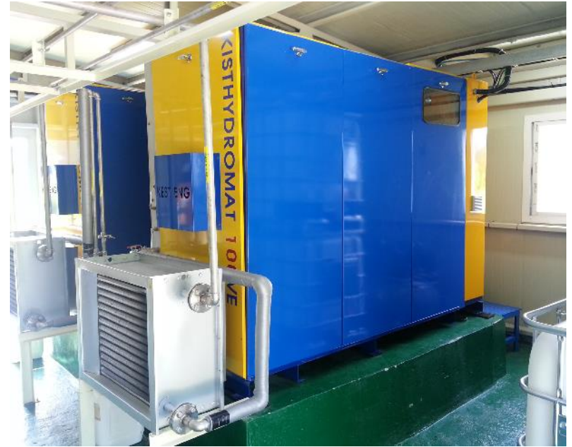
고려노벨화약 고성공장 고농도 총질소 폐수 일일 4톤 처리
